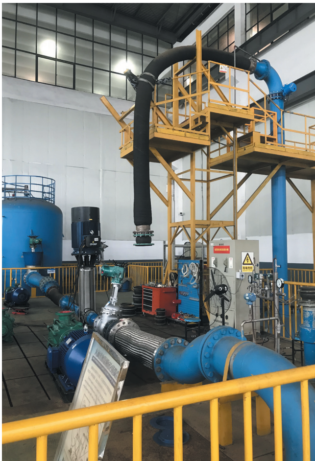
Испытательный стенд на заводе CNP в Китае
